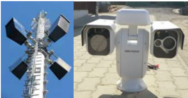
Abbildung 6: Mast UTA STEINBACH mit Audio-, Videoanlage
